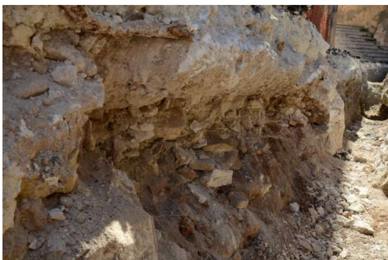
Fig. 28 - CAGLIARI - Ex Manifattura Tabacchi. Sezione tra i due blocchi (foto C. Buffa)
