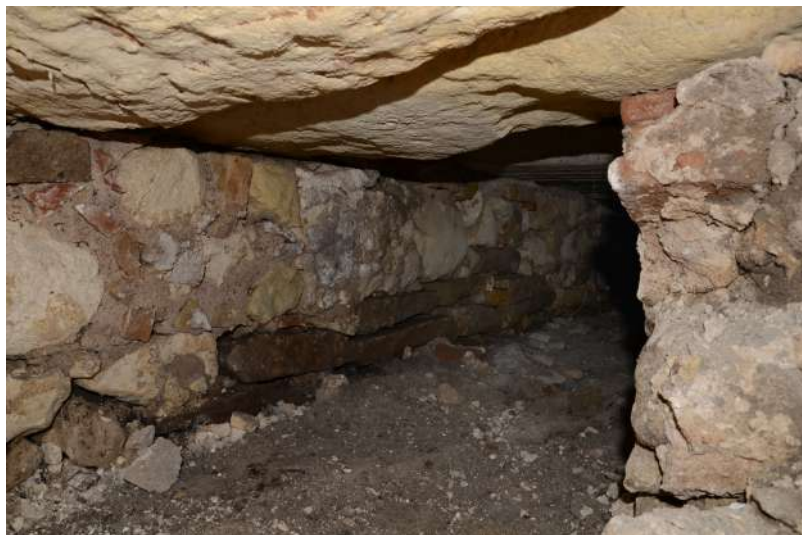
Fig. 26 - CAGLIARI - Ex Manifattura Tabacchi. Veduta dell'interno della cloaca e dettaglio della messa in opera (foto C. Buffa)
