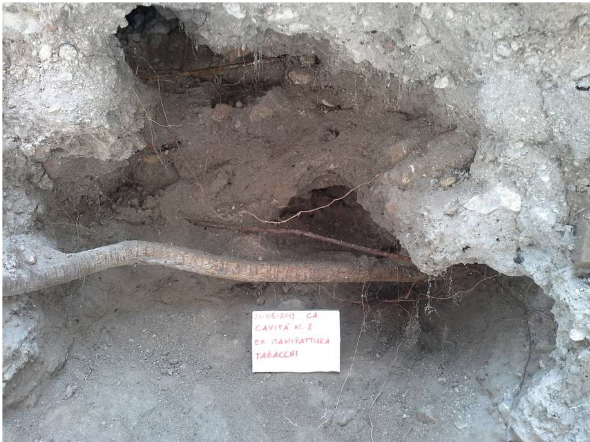
Fig. 16 - CAGLIARI - Ex Manifattura Tabacchi. Muro di contenimento lato via XX Settembre, dettaglio (foto C. Nieddu)
