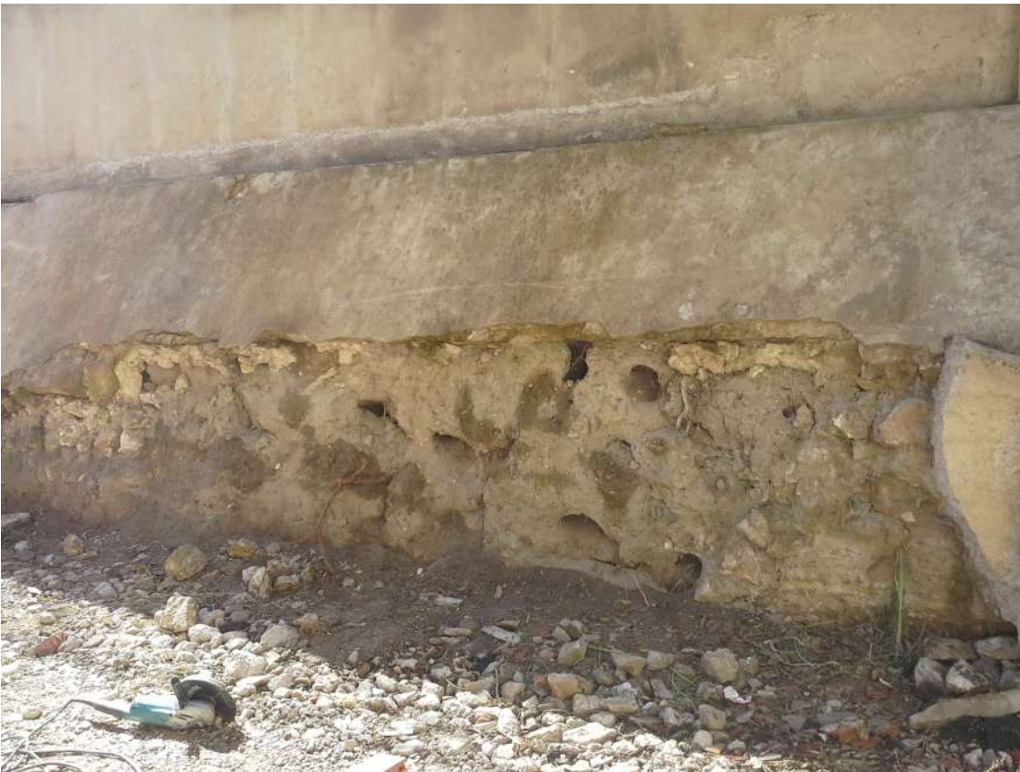
Fig. 15 - CAGLIARI - Ex Manifattura Tabacchi. Muro di contenimento lato via XX Settembre, particolare della porzione ammalorata (foto C. Nieddu)
