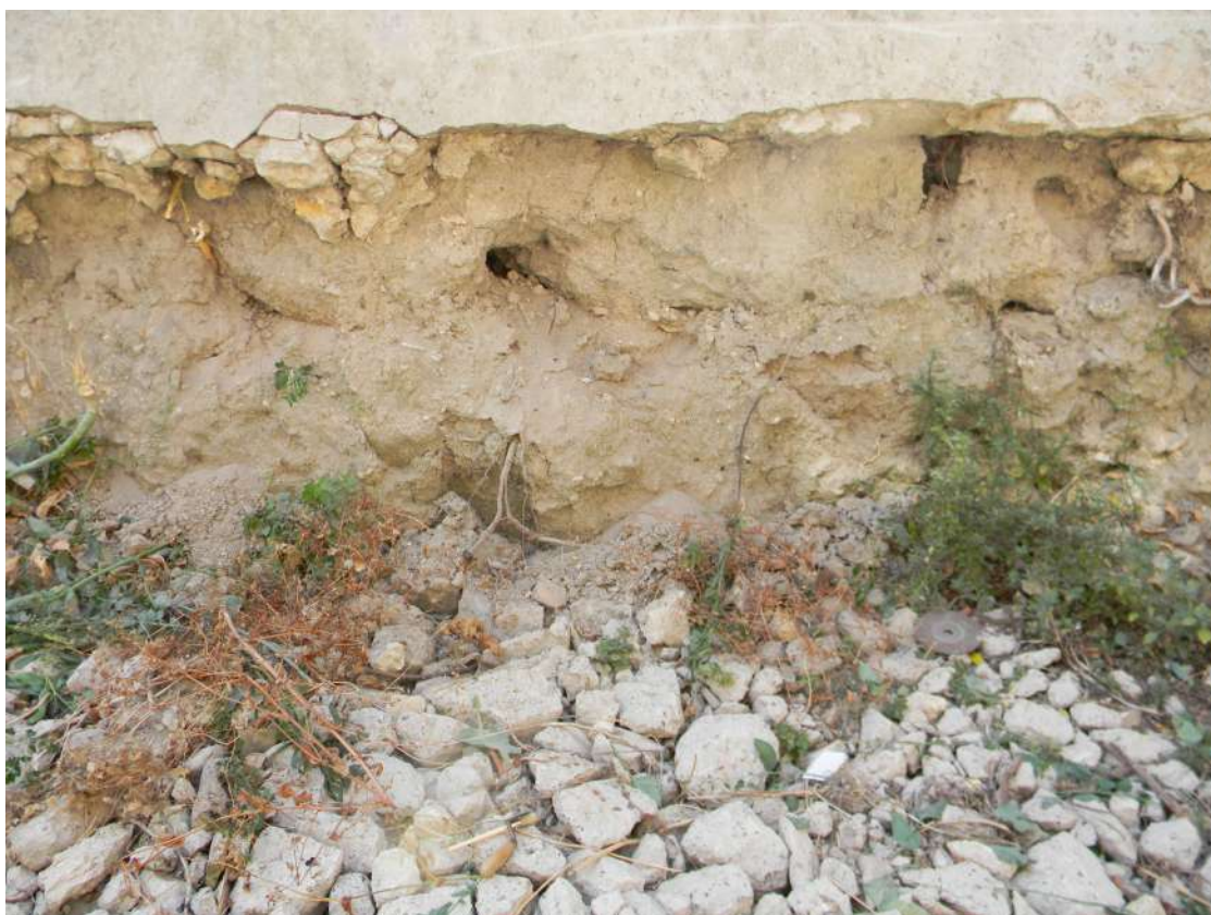
Fig. 14 - CAGLIARI - Ex Manifattura Tabacchi. Muro di contenimento lato via XX Settembre, particolare della porzione ammalorata (foto C. Nieddu)
